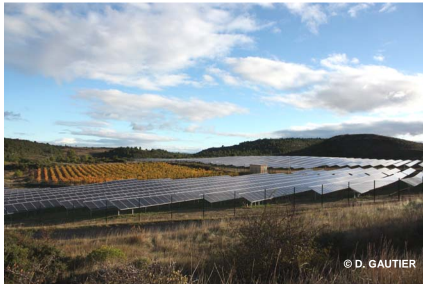
Figure 20 : Parc photovoltaïque de Talairan
